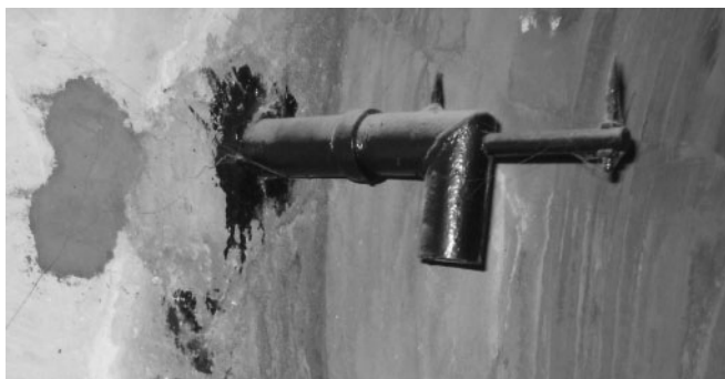
Abb. 8: Messeinrichtung im Kontrollgang der Untergrundabdichtung von Bou Hanifia
